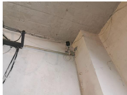
图 10-10 探伤室内监控
