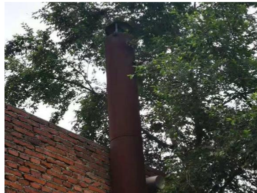
图 10-13 探伤室外排风
