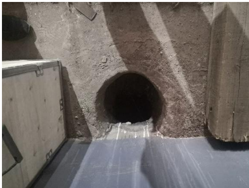
图 10-12 探伤室内通风口
