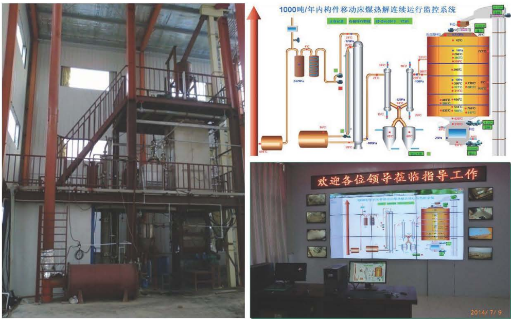
图 3.2-1 千吨级新技术热解试验装置和控制界面图
